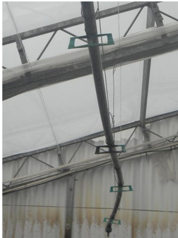
Fig. 3: Impianto a pioggia
